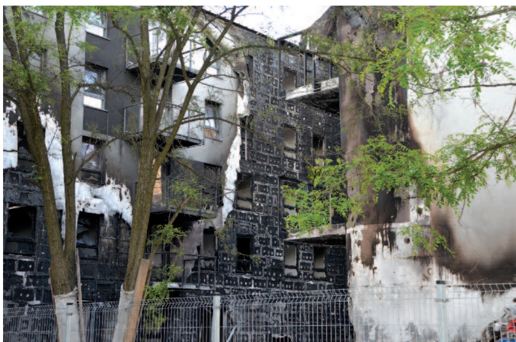
1. Nowy wielorodzinny budynek mieszkalny po pożarze
