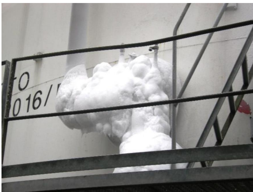
Zawór całkowicie pokryty lodem staje się niefunkcyjalny
